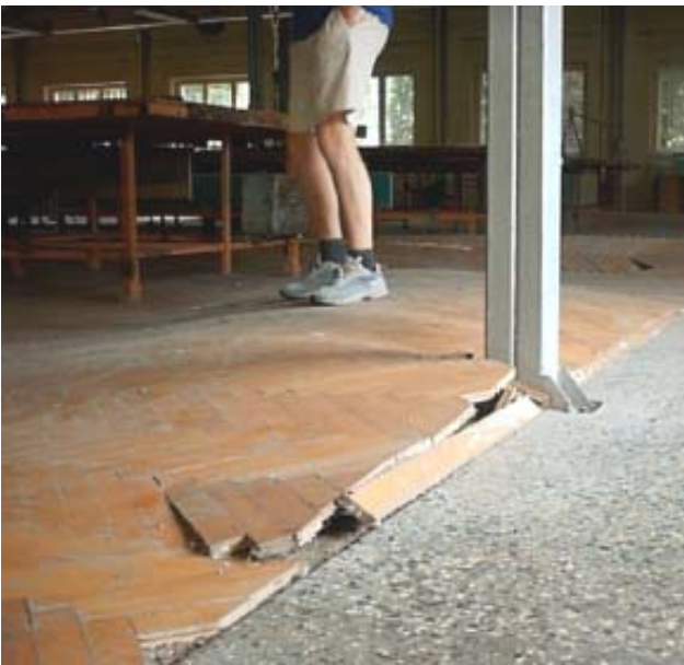
A parketta ára a többszöröse az aljzaténak. A hibát az aljzatbeton nedvessége okozta.
